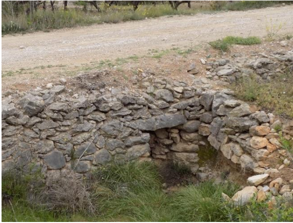
Imatge 7. Desguàs del Tram III del Perelló.
